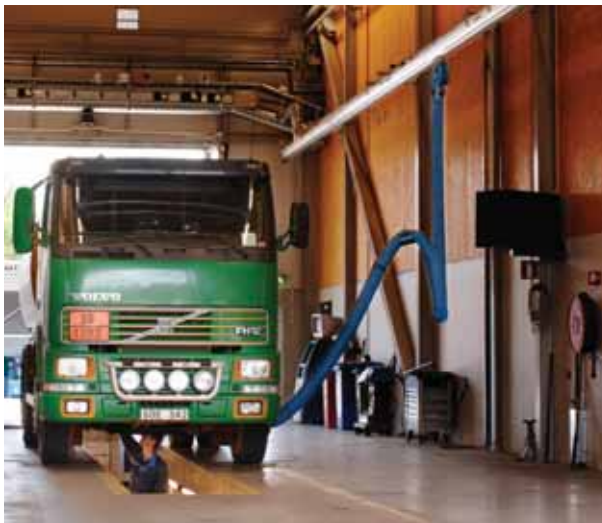
Пример системы для удаления выхлопных газов при техническом осмотре транспортных средств.
